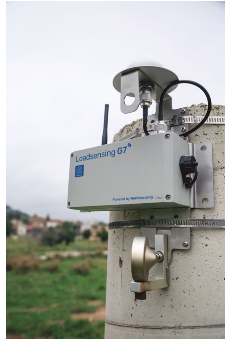
Instal·lació del sensor desenvolupat en el projecte.
